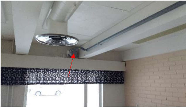
Kuva 4. 1.kerrosen lattian alapuolella kulkevat talotekniikkakanaalit on alipaineistettu. Kuvassa poistopuhallin ja -kanava ruokalatilassa. Kanaalien alipaineisuutta ei tarkistettu.
