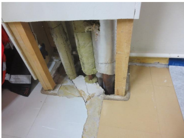
Kuva 17: Ruokala, tiivistämättömiä läpivientejä putki-kanaaliin
