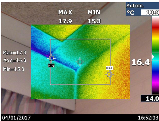
Kuva 13: Luokka 242, ulkoseinän ja väliseinän nurkka, normaalipaine
