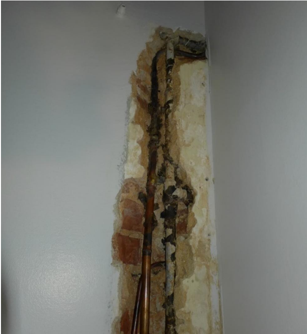
Kuva 1. Seinän sisällä olevien vanhojen vesiputkien ympärillä on PAH-yhdistepitoista tervapaperia.
