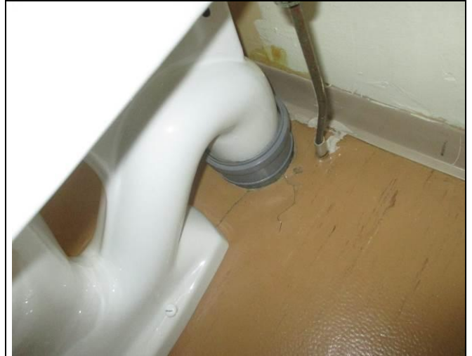
Kuva 52. Vanhan osan wc-tiloissa havaittiin lattia- pinnoilla halkeamia
