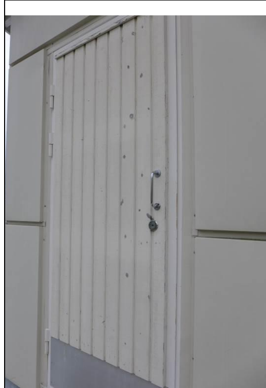
Kuva 36. Vanhan osan vesikatolle johtava ulko-ovi vaatii kunnostusta.
