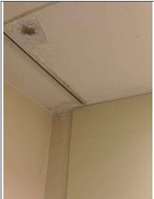
Kuva 22. Näyttämön kohdalla havaittiin kaksi vesivauriota sisäkattopinnalla.
