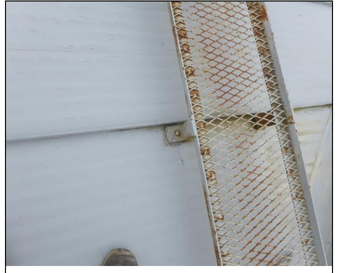
Kuva 40. Kaikki kulkusillat on kiinnitetty ruoteisiin vesikatteen läpi.
