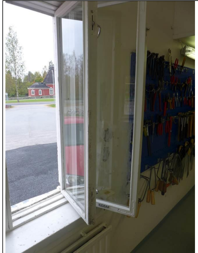
Kuva 32. Ikkunoiden käynneissä on tarkastetuina osin suuria ongelmia.
