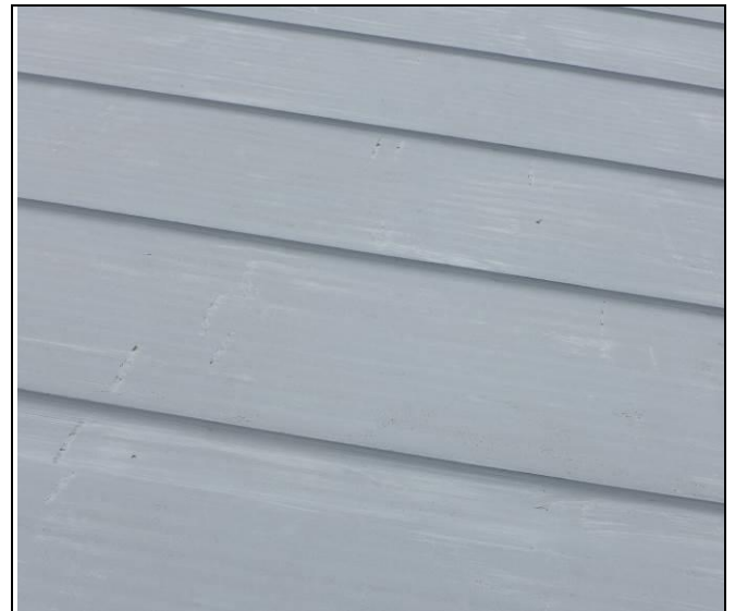
Kuva 42. Laajennusosan puolella katepinnalla havaittiin kolhuja/painaumia, joiden kohdille on syntynyt ruostevaurioita.
