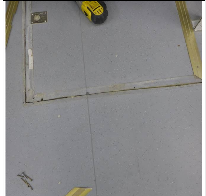
Kuva 14. Kanaaleiden tarkastusluukkuja ei ole tiivistetty.
