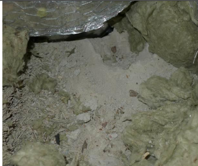
Kuva 19. Vanhan osan yläpohjan IV-läpiviennit ovat tiivistämättä molemmin puolin.
