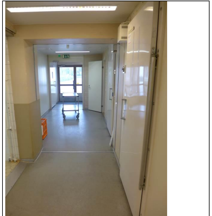
RAK-kuva 10. Keittiökäytävän 126 lattiarakenteessa havaittiin pintakosteudenosoittimella kohonneita pintakosteusarvoja
