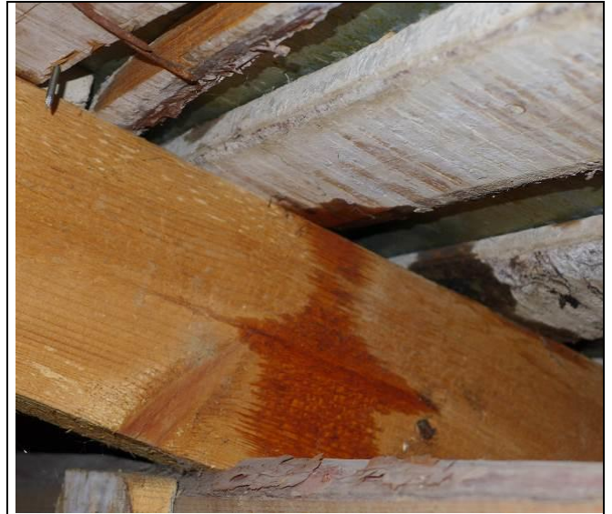
Kuva 20. Vanhan osan yläpohjassa havaittiin vesivuotojen aiheuttamia jälkiä kattotuolien paarteissa sekä ruodelaudoituksissa.
