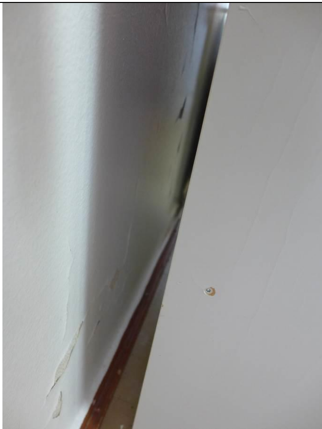
Kuva 45. Ulkoseinäpinnoilla on havaittavissa paikoin myös pinnoitteiden irtoilua, joka saattaa johtua liian tiiviistä pinnoitekerroksesta.
