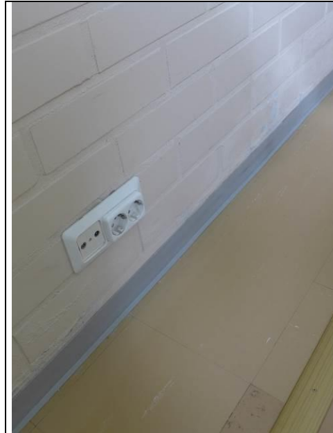
Kuva 48. Keittiön pesupisteiden kohdilla seinäpintojen maalit hilseilevät ja seinäpinoilla todettiin kohonneita pintakosteusarvoja.
