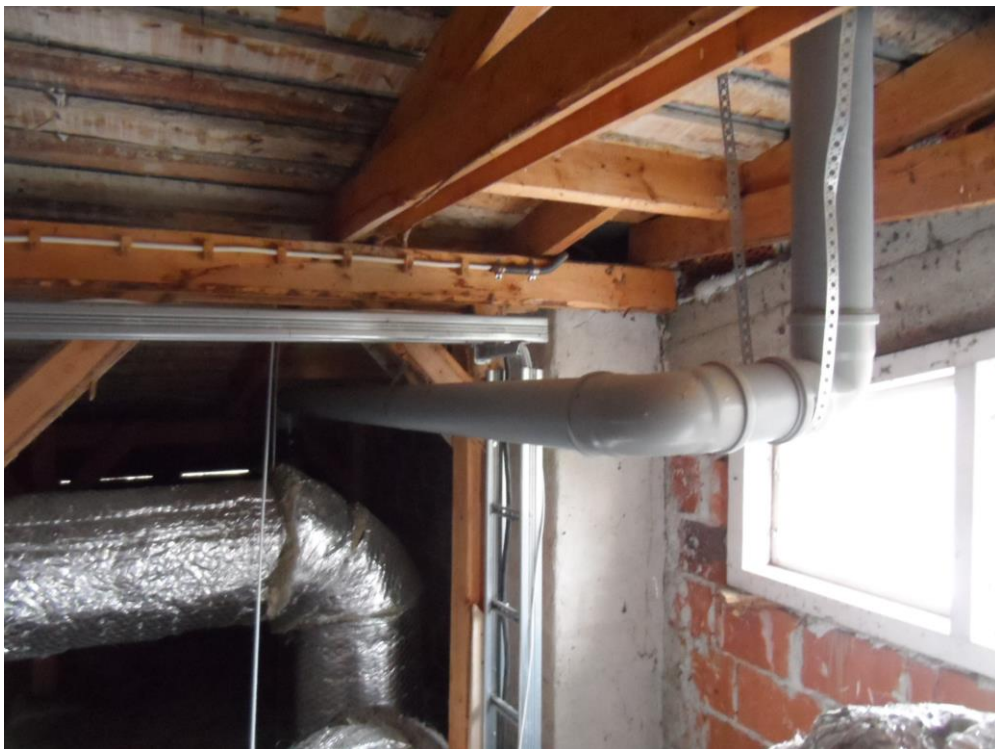
Ullakolla on eristämättömiä viemärin tuuletusputkia.
