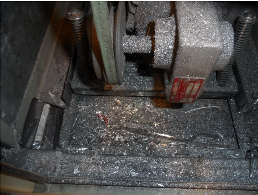
Laajennusosan iv-koneen LTO tekee lastua. Korjattava.
