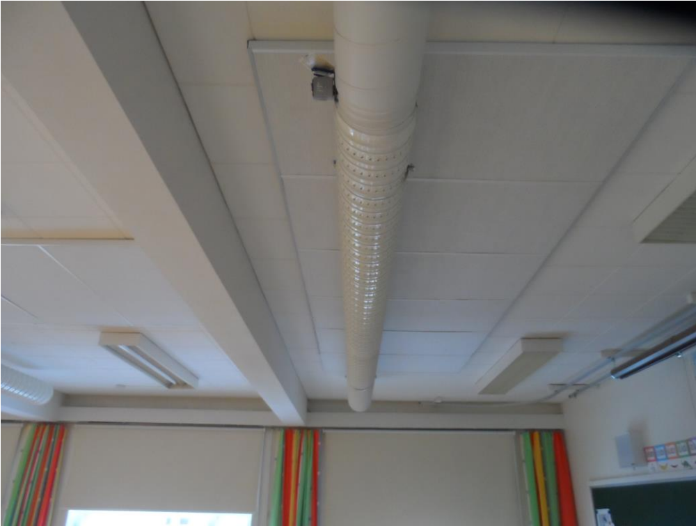
Luokkien tuloilma-reikäkanavat puhaltavat suoraan alaspäin.
