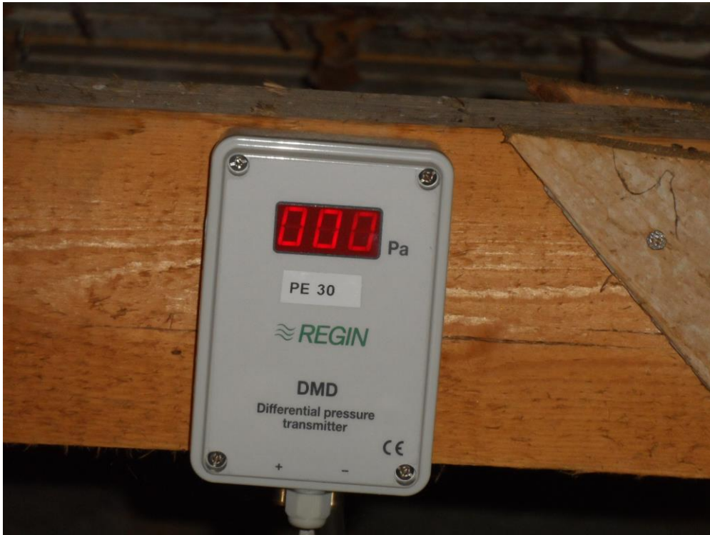
Liikuntasalin poistoimurit päällä, silti kanavan paineanturi näyttää 0Pa. Mikäli arvo vaikuttaa muihin säätöihin, niin väärää infoa jaetaan.
