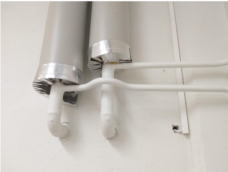
Kuva 2. Mineraalivillaa ja tiivistämätön läpivienti
