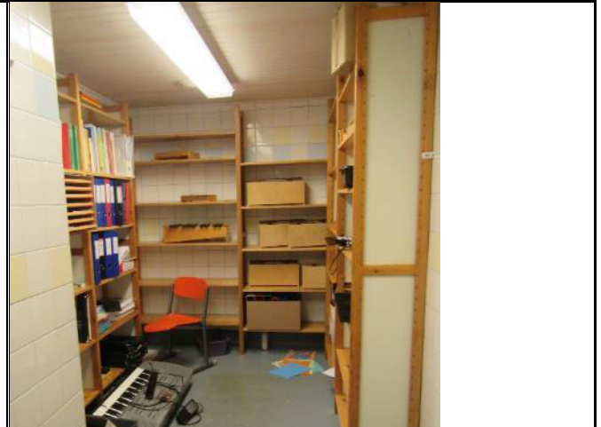
Kuva 65. Musiikkiluokan varastossa oli tunkkainen haju. Puutteellinen ilmanvaihto (ei tuloa).
