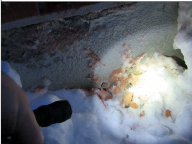
Kuva 32. Sokkelin rakenneavaus 32mm reikä. Rakenteessa ei havaittu toja,eristettä kuten suunnitelmissa esitetty. Eristeenä villa.
