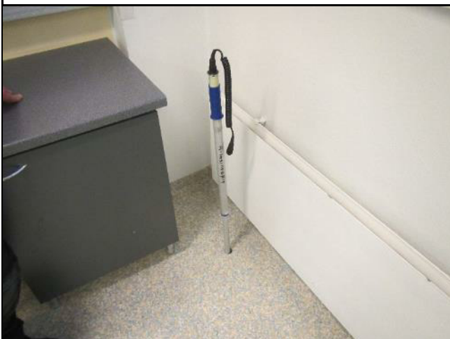
Kuva 9. AP3: Alapohjarakenteesta löytyi ulkoseinän reunalta n. 25cm korkea kanaali/kotelotila. Tila havaittiin ra- kennuksen molemmilla pitkillä sivuilla. Reiässä to- dettiin mikrobivaurioon viittaava haju. Todettiin ilma- virta porareistä sisäilmaan.
