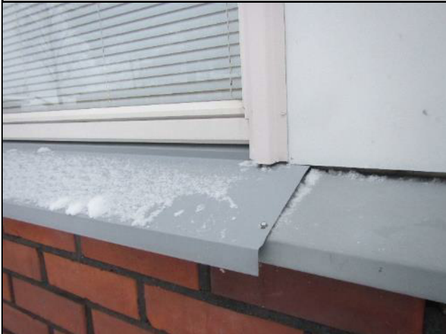
Kuva 36. Ikkunapellitykset tehty limittämällä uudempi pelti vanhaan n. 20-30mm. Pellit erin mittaisia.
