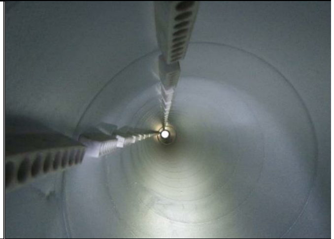
Kuva 71. 2.krs luokan tuloilmakanavan sisäpuolta. Kanavan pohjalla on kellertävää pölyä.
