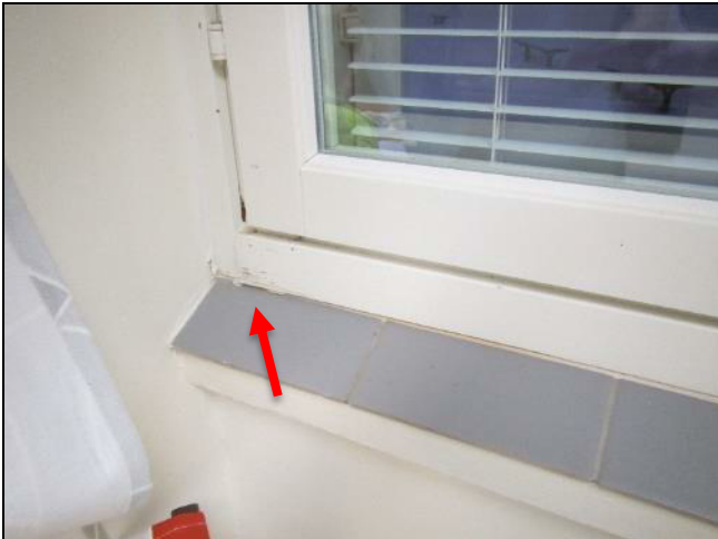
Kuva 42. Ikkunakarmien alueilla monin paikoin pistemäisiä vuotokohtia. Paikoin havaittiin myös viivamaisia vuotoja kohdilla, joissa silikonit irronneet pidemmältä matkalta.
