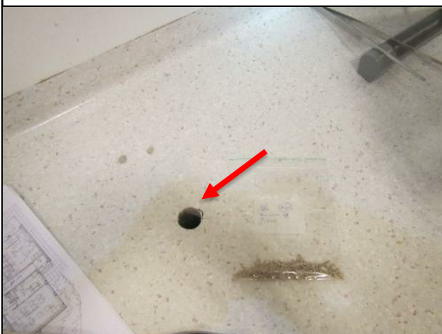
Kuva 15. RE5. Tarkistusreiästä tuli voimakasta pien/öljyn hajua. Hajua voi viitata kastuneeseen pikieristeeseen.
