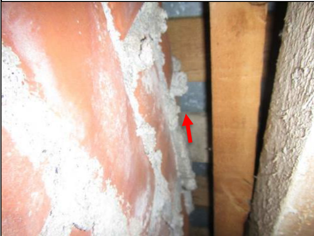
Kuva 48. Lumi päässyt yläpohjaan todennäköisimmin ruodelautojen välistä kovalla tuulella.
