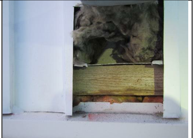
Kuva 31. US4 ulkoseinää peltiverhoilun kohdalla ei ole toimivaa tuuletusta. Eristevillat pellissä kiinni ja pellityksen "rimojen" kohdalla kiinnikkeet. Tuulensuojalevy puuttuu rakenteesta
