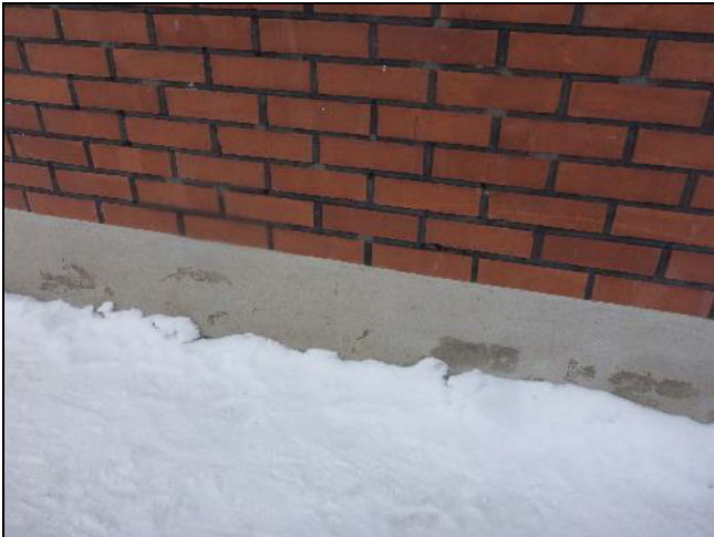
Kuva 34. Ulkoseinän tiiliverhouksen alareunoissa ei ole tuuletusreikiä (ei myöskään tuuletusväliä tiiliverhouksen takana).
