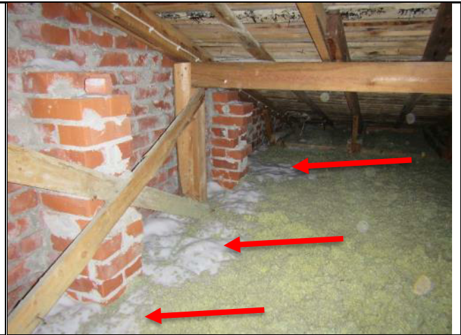
Kuva 47. Eteläpäädyssä oli lunta villojen päällä koko seinän matkalla.
