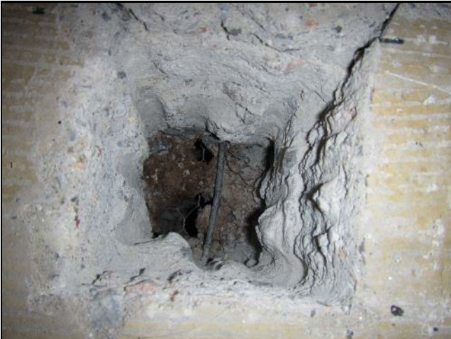
Kuva 55. 210 Siivouskomeron rakenneavauksesta havaittiin, ettei välipohjarakenne vastaa suunnitelmia (VP1). Pohjalla näkyvä tumma materiaali on korkkieristettä.
