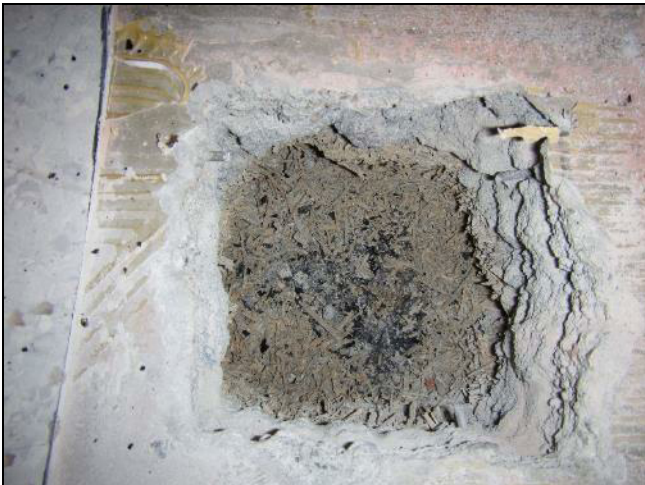
Kuva 7. AP1: Rakenneavauksesta löytyi alkuperäinen Toja- levy sekä pikisively pohjalaatan päältä. Raken- neavauksesta tuli pistävä pien haju.
