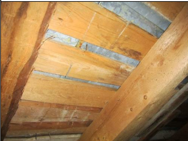
Kuva 50. Konesaumapellityksen alla ei ole aluskatetta. Ruodelaudoitus tiheällä jaolla. Ei havaittu merkittäviä jälkiä kondenssikosteudesta ruodelaudoituksessa eikä puhallusvilloissa kosteusjälkiä.
