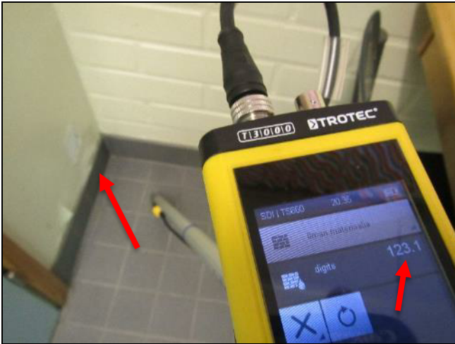
Kuva 11. Liikuntasalin kellarin korjatun luiskan kohdalla on korkeita pintakosteuslukemia ja näkyvää kalkkihärmettä lattianrajoilla.
