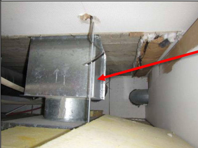
Kuva 72. Opettajanhuoneen eteisessä alakattomallinen tuloilmalein.
