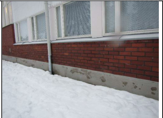
Kuva 35. Erityisesti itäisivulla sokkelissa pintavaurioita. Osassa vauriokohtia näkyy ruostuneita betoniteräksiä. Sokkeliin kohdistuu kosteusrasitusta.
