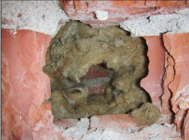
Kuva 30. US2. Rakenteessa ei selvää tuuletusrakoa.
