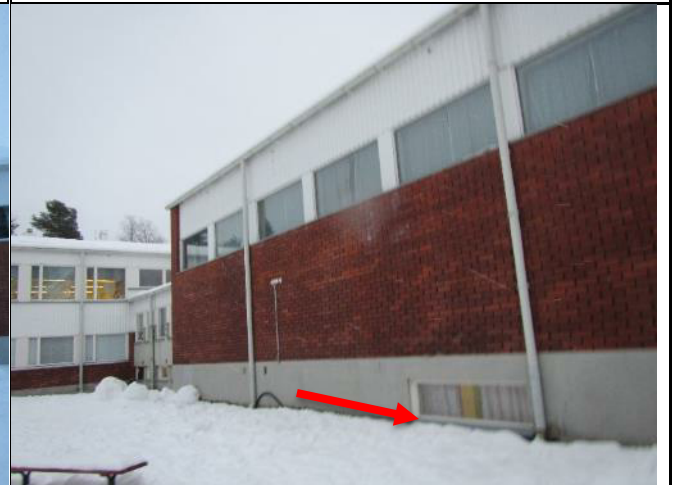
Kuva 4. Vanha luiskan paikka, joka ummistettu 80-luvun korjauksessa. Todennäköistä että vanha luiska jätetty paikalleen (kellarin puolella seinä samalla kohtaa märkä).
