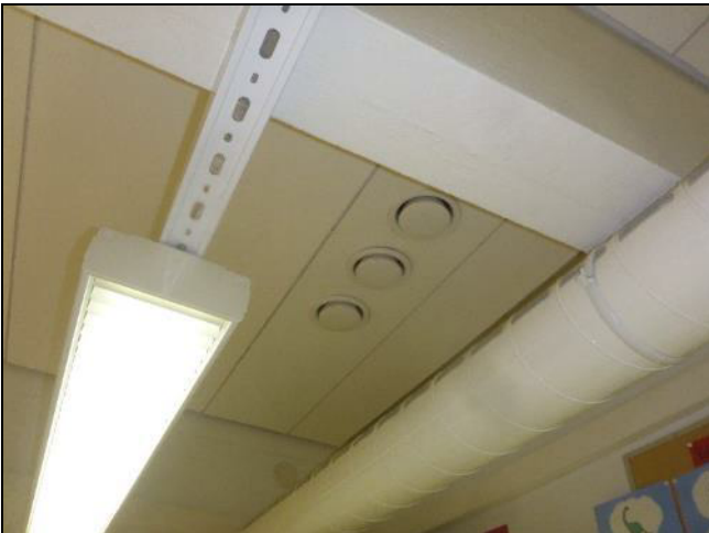
Kuva 66. Poistoilmaventtiileitä luokan katossa ja tuloilma putki alla. Ilmanvaihdossa syntyy osittain oikosulkuvirtaus.
