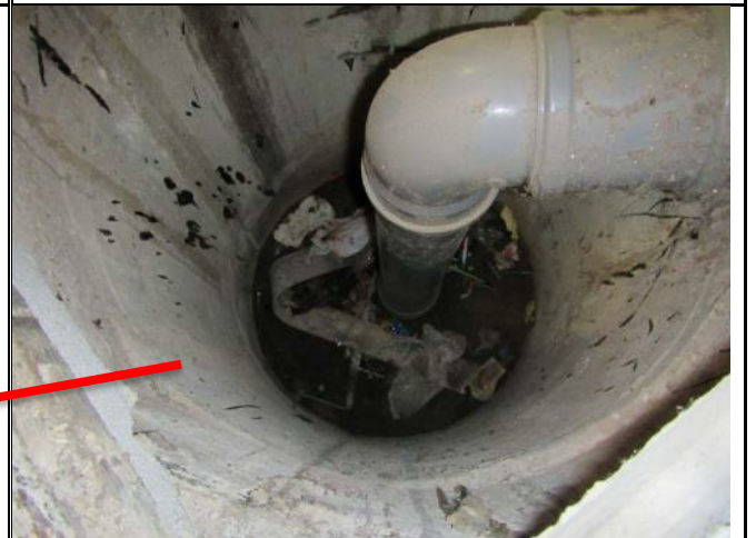
Kuva 20. Em. luukussa viemäriputki. Kaivon pohjalla runsaasti sakkaa tms. ainesta. Kaivosta ilmayhteys sisäilmaan.
