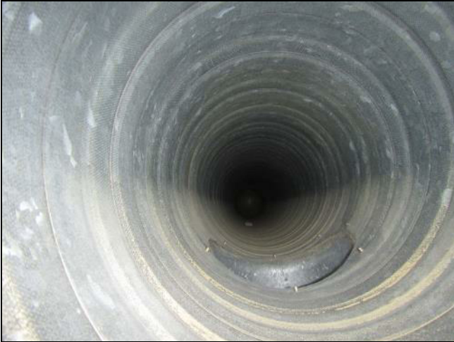
Kuva 70. Kuvaamataitoluokan tuloilmakanavassa on kellertävää pölyä.
