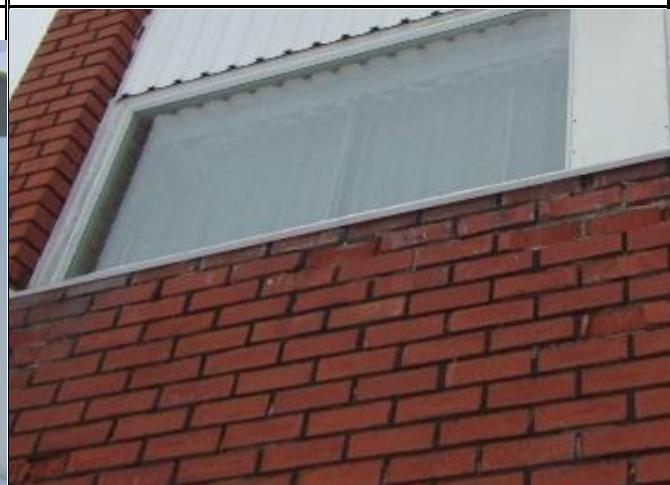
Kuva 39. Erityisesti länsijulkisivulla tiilissä yksittäisiä pakkasrapatumavaurioita, ilmeisesti materiaalin laadunvaihteluista. Seinä on sateelle altis.
