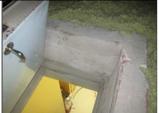
Kuva 53. Kulku yläpohjaan on luukun kautta tikkailta. Tikkaiden tuentaa ei ollut, käynti ei ole turvallista.
