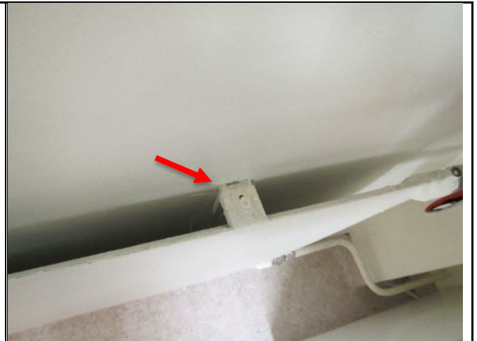
Kuva 43. Patterikiinnikkeissä havaittiin yksittäisiä vuotokohtia.
