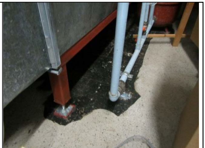
Kuva 59. Sisäänkäyntiaulan yläpuolella IV-konehuoneessa mustaa liimaa jäänyt lattiaan (mahdollisesti sisältää asbestia).
