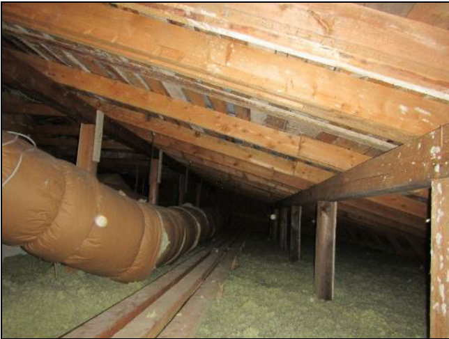
Kuva 46. Yleiskuva, kulkusilta sijaitsee yläpohjassa vain toisella puolen lapetta. Yläpohjassa tunkkainen hajuu.
