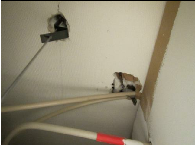
Kuva 62. Opettajanhuoneen eteisen alakaton taustalla asbestipitoista levyä. Levyä rikottu alakaton kiinnikkeitä ja putkia varten.
