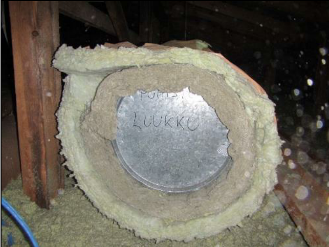
Kuva 52. IV-kanavien puhdistusluukku. Luukkuja ei avattu. Paljas metallipinta puhdistusluukun kohdalla voi aiheuttaa kosteuden tiivistymistä IV-kanavan sisäpintaan
