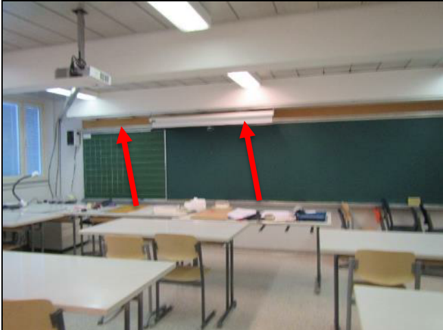
Kuva 68. 101 Kuvaamataitoluokassa tuloilmaventtiilit ovat liitutaulun päällä. Merkkisavulla havaittiin, että tuloilma huuhtelee vain luokan etuosaa.
