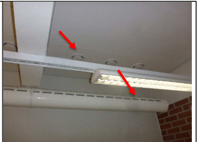
Kuva 67. Poistoilmaventtiileitä luokan katossa ja tuloilma putki alla. Ilmanvaihdossa syntyy osittain oikosulkuvirtaus.
