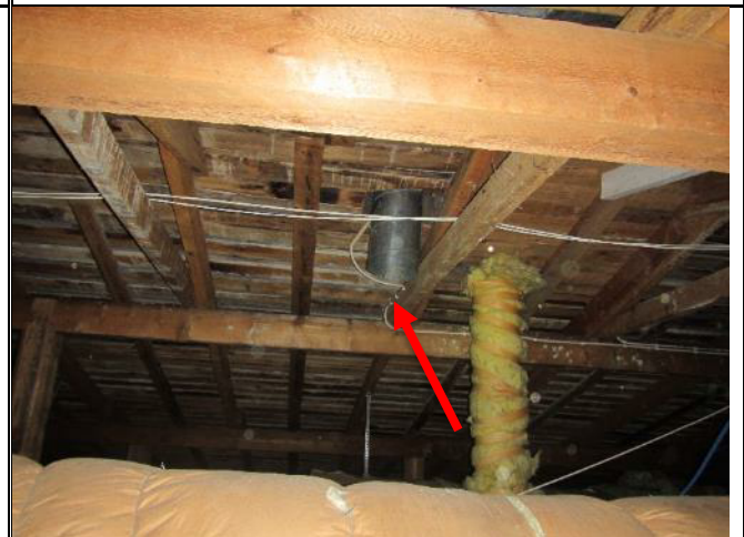
Kuva 51. Yläpohjassa yksi poistopuhallin vesikatolle. Puhallin oli päällä molemmilla käyntikerroilla, kun yläpohjassa käytiin.
