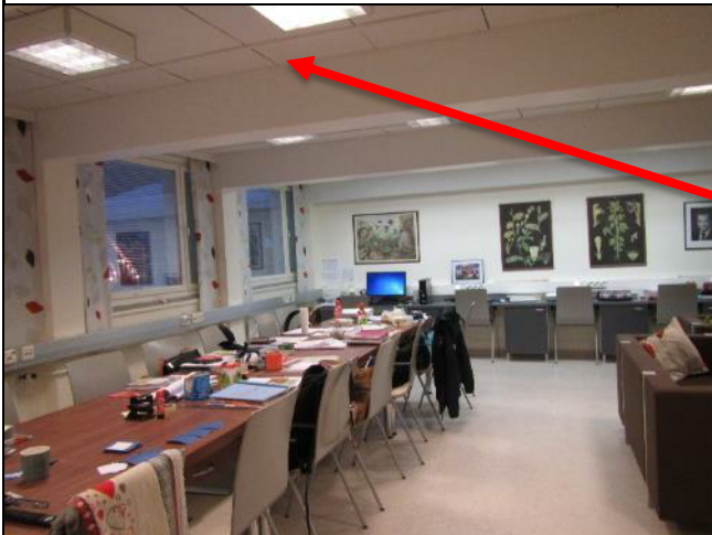
Kuva 60. Opettajanhuoneen katossa akustovillalevyjä. Ei reunakäsittelyä levyjen saumoissa.
