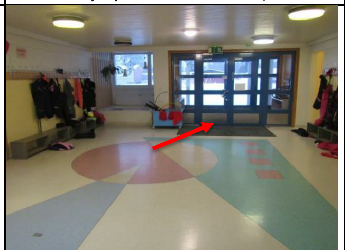
Kuva 16. Tuulikaapissa todettiin tunkkaista hajua. Oviaستن kohdalla havaittiin reikiä alapohjalaatassa, jossa voi olla ilmayhteys lattiaan. Hajua voi olla peräsin alapohjasta.
