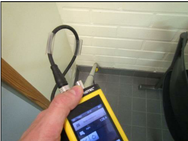
Kuva 26. Liikuntasalin kellarin luiskakorjauksen alueella seinärakenteessa korkeat pintakosteudet. Rakenteessa villaeriste tiilimuurauksen takana.
