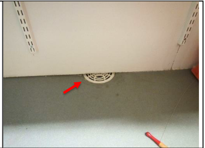
Kuva 12. Musiikkiluokan varastohuoneessa on tunkkainen hajua. Tilassa on kaksi kuivana olevaa ”märkä”kaivoa, joissa ei vettä tarkastuksen yhteydessä. Voimakasta viemärinhajua ei kuitenkaan havaittu.
