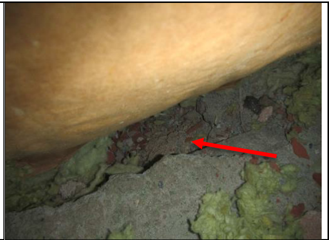
Kuva 45. Puhallusvilloja käytettiin auki IV-kanavan läpivienistä ja havaittiin, että yläpohjarakenteessa paloperkammon alla on Toja-levyä.
