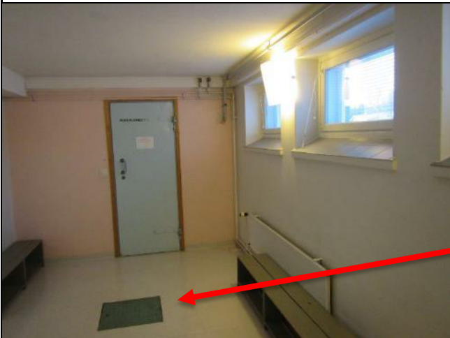
Kuva 19. Kellarin 012 eteisessä luukku lattiassa. Luukku ei ole tiivistetty.
