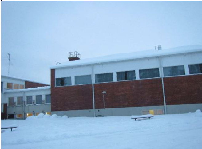
Kuva 3. Saatujen tietojen perusteella rakennuksen liikuntasaliin alueelle tehty salaojajorjauksia.
