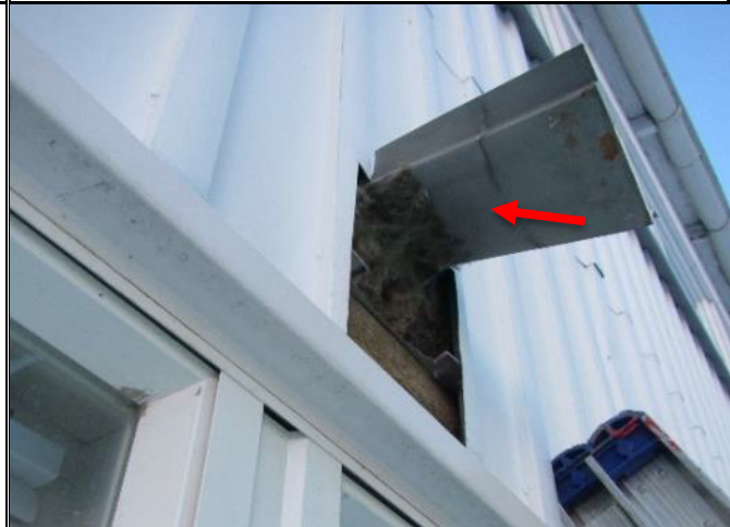
Kuva 37. Peltijulkisivulla Villat ovat jäätyneet kiinni peltiin rakenneavauskohdassa. Rakenteessa on todennäköisesti ollut kosteutta.
