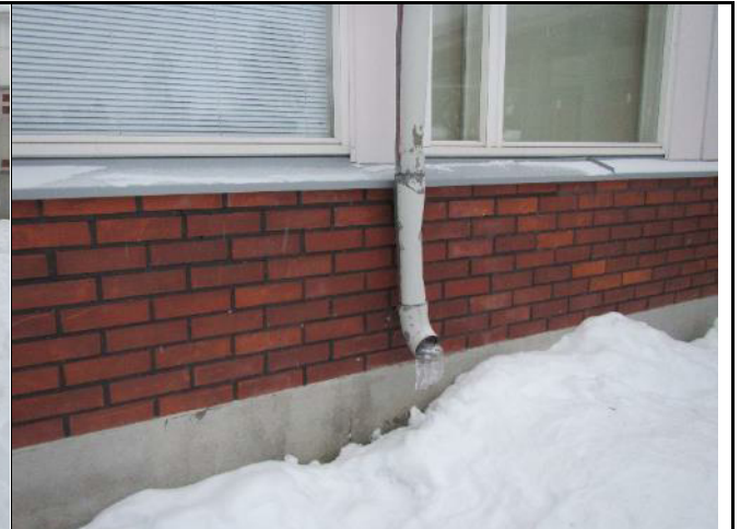
Kuva 2. Rikkoontunut ja jäätynyt syöksytorvi. Ulosheittäjä on liian korkealla, josta aiheutuu tarpeetonta roiskevesirasitusta sokkelipinnalle.
