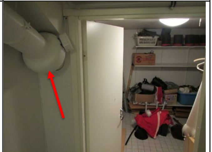
Kuva 29. Tila alipaineistettu kanavapuhaltimella.
