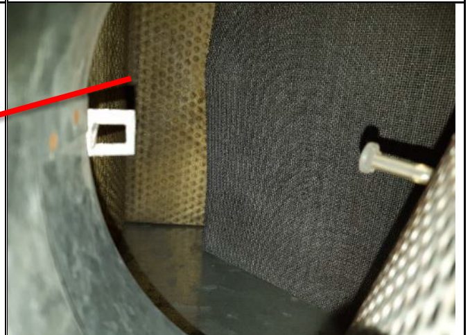
Kuva 73. Ilmanvaihtolimessä on keltaista lasivillaa sisäpuolella. Villalevyissä ei ole pintakäsittelyä, lasivillaa voi irrota ilmavirran mukana sisäilmaan.
