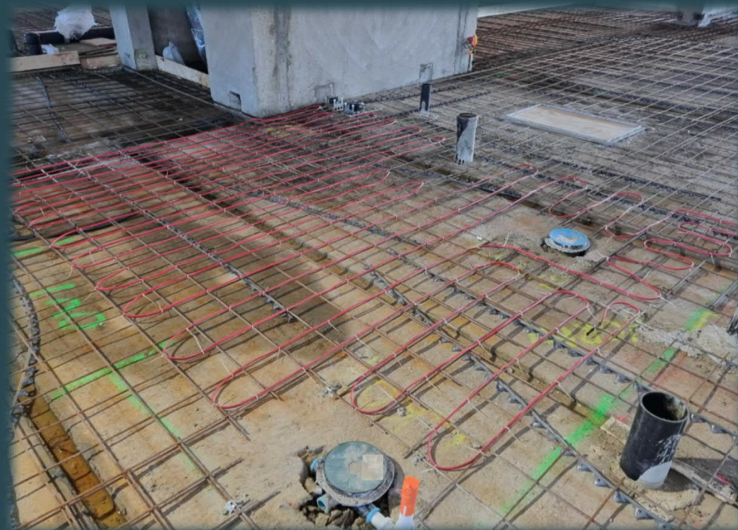
2. Kerroksen vessan sähkölattialämmitys
