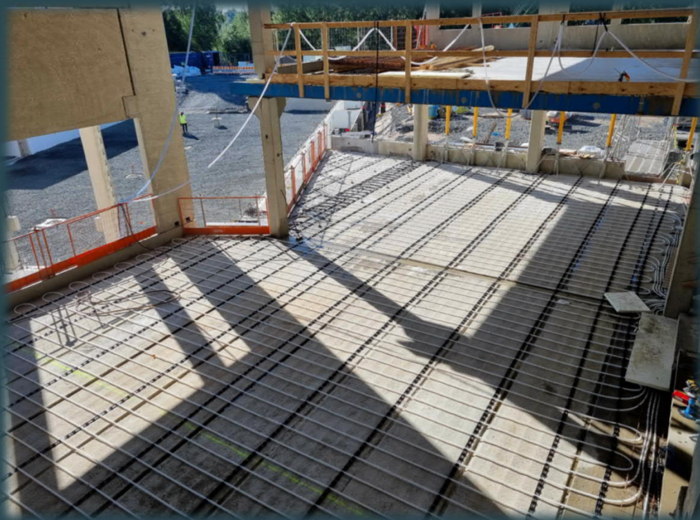
Vesikiertoinen lattialämmitys 1. kerroksen aulassa
