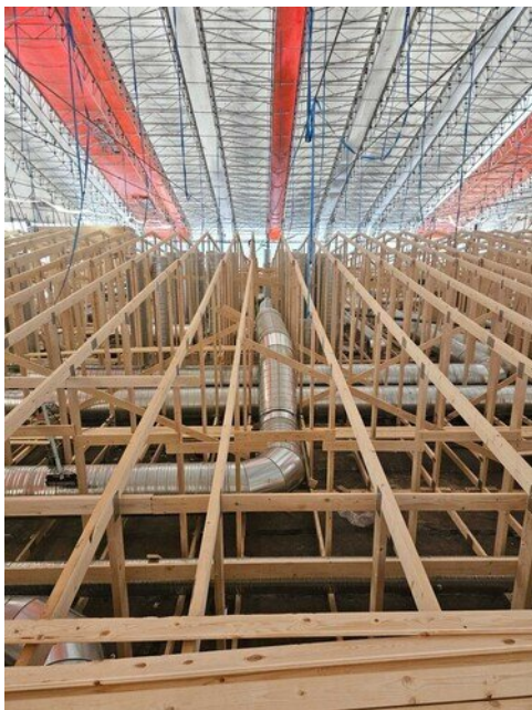
LVI-tekniikkaa kattotuolien välissä
