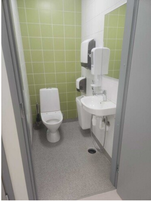
Wc varusteltu, lattiakaivon kansi ja pytyn kansi puuttuu
