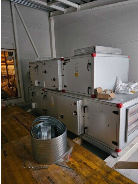
Iv-kone uudessa iv-konehuoneessa
