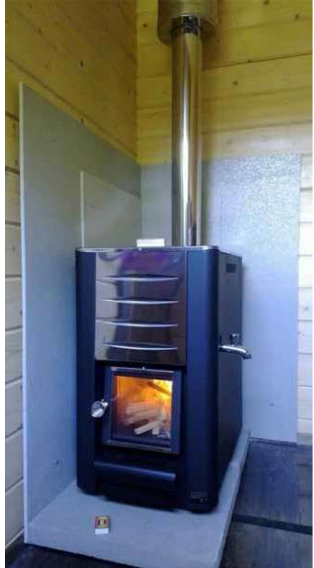
Kuvassa CE-merkityn kiukaan suojaetäisyyttä palava-aineisiin materiaaleihin on pienennetty virheellisesti tavoilla, joita ei ole kuvattu kiukaan asennusohjeissa eikä testattu harmonisoidun tuotestandardin edellyttämällä tavalla. Kuva FISE-virhepankista.
