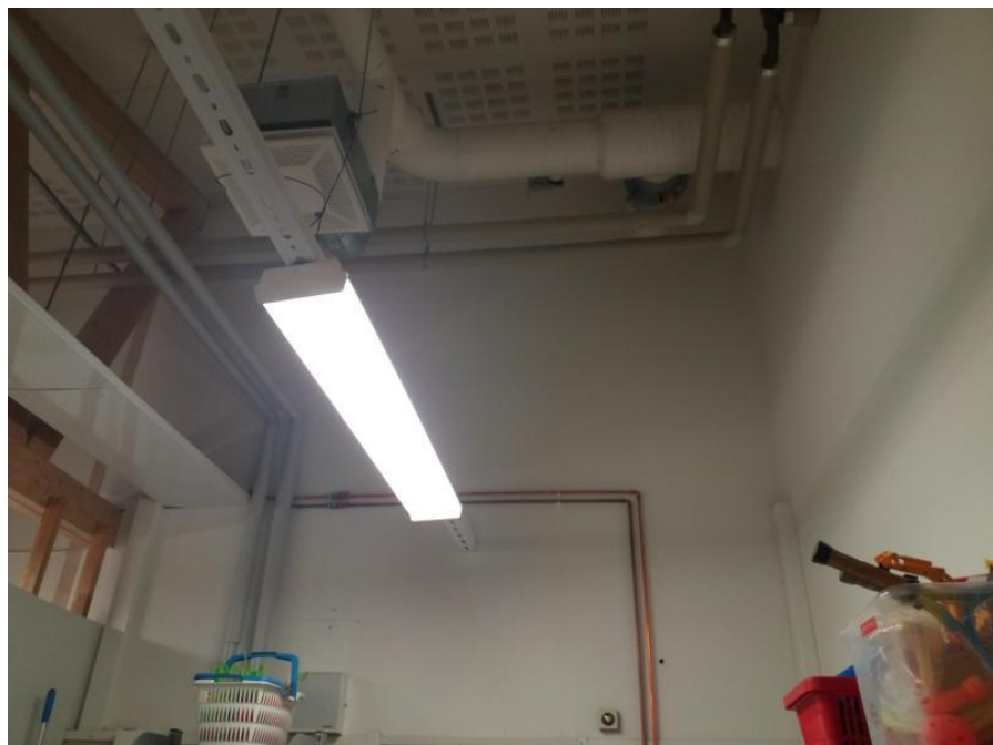
Käytävän vastaisella puolella olevista tiloista ei havaittu kosteutta
