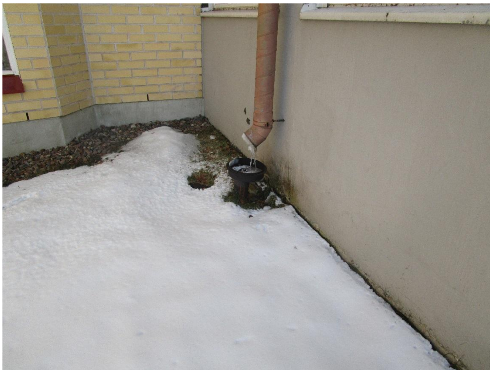
Kuva 3.5 Sadevedenohjaus pääasiassa hallitusti suoraan sadevesikaivoihin. Kyseisessä kohdassa sadevesi pääsee hieman rasittamaan seinärakennetta.
