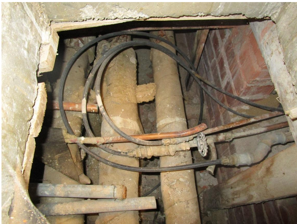
Kuva 3.7 Alapohjan alla kulkeva putkikanaali. Kanaalissa on muotti- ja tukilautoja sekä rakennusjätettä.
