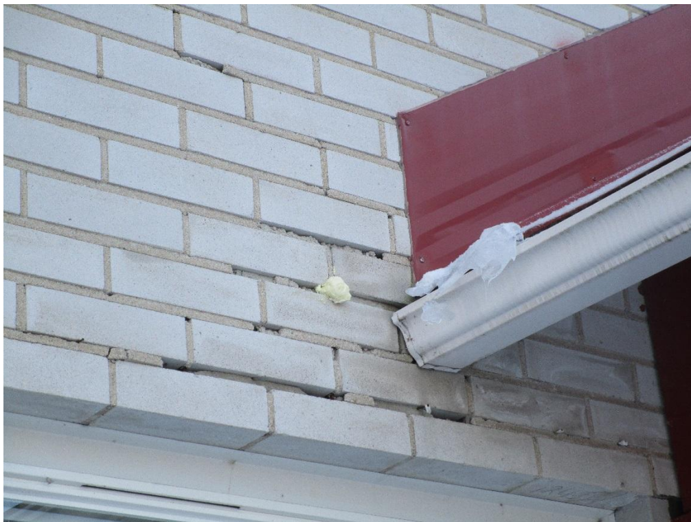
Kuva 3.1 Detaljipuute keittiön eteisen katoksen vedenohjauksessa. Ulkoseinän tiiliverhouksen laastisaumat ovat rapautuneet paikoin.
