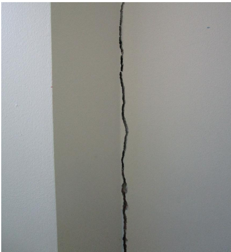
Kuva 3.9 Rakenteeseen syntynyt liikuntasauma toisessa kerroksessa uuden ja vanhan osan välissä.
