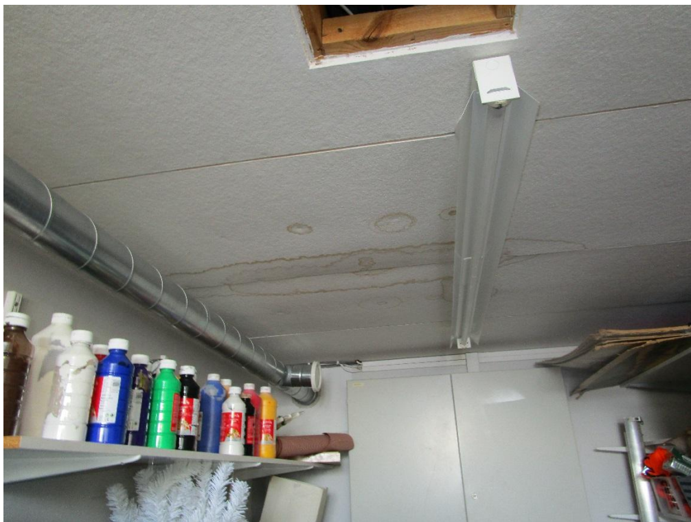
Kuva 3.11 Varaston/IV-konehuoneen alaslasketussa katossa kosteusjälkiä. Kosteus pääsee ulkosäleikön kautta kanavistoon.
