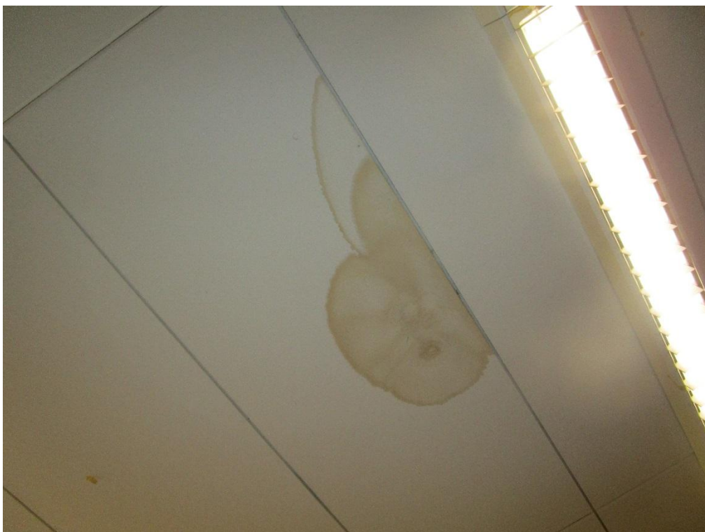
Kuva 3.10 Toisen kerroksen luokahuoneessa akustiikkalevyssä kosteusjälki, joka on todennäköisesti vanha.
