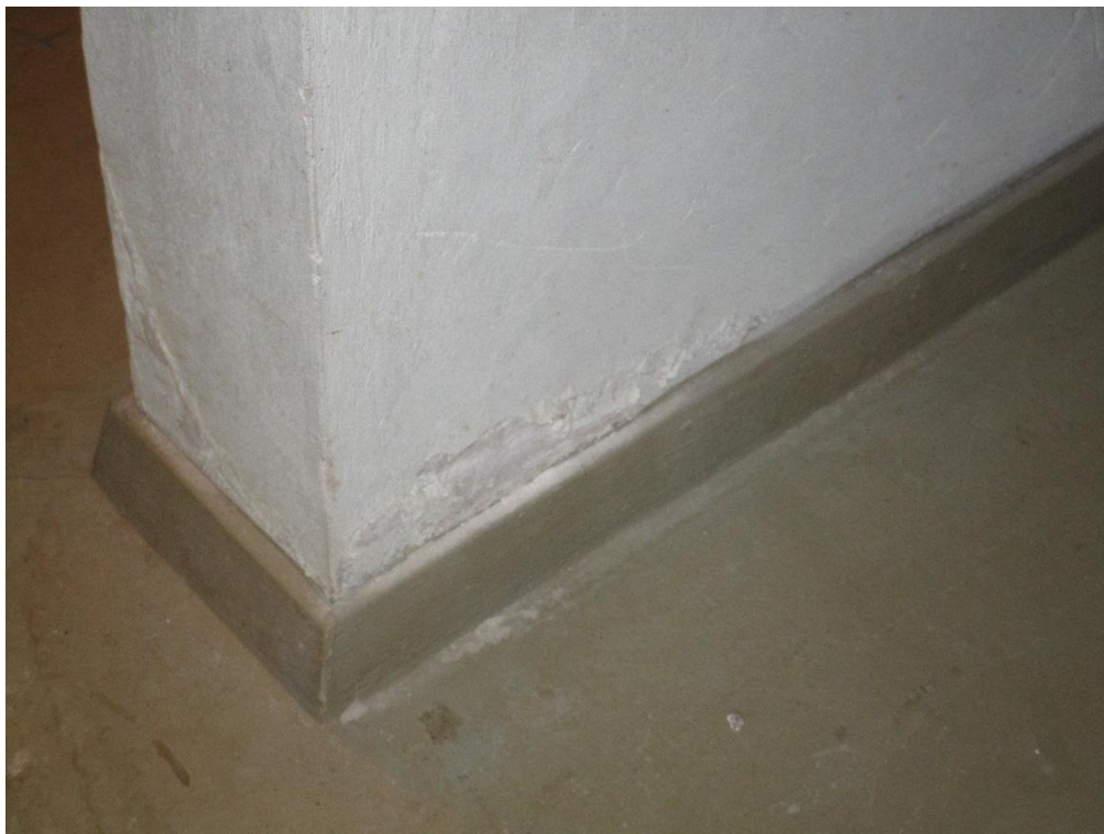
Kuva 3.8 Teknisen tilan seinän alaosassa on havaittavissa kalkkihärmettä, joka viittaa kosteuden nousuun rakenteessa.
