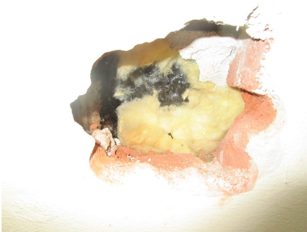
Kuva 3.13 Musiikkiluokan varaston maanvastaiseen seinään tilaajan toimesta suoritettu rakennearaus.
