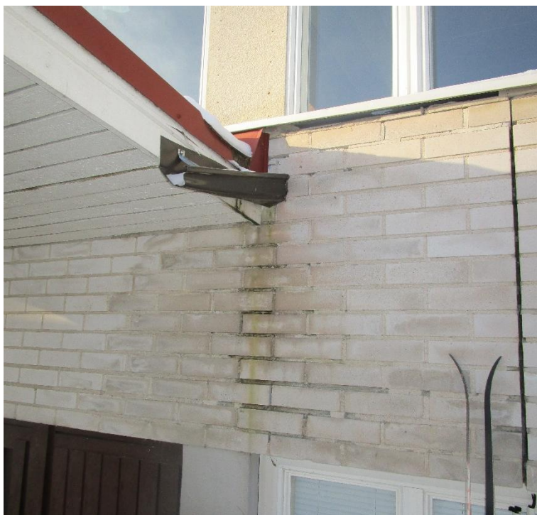
Kuva 3.2 Detaljipuutteita kellarin katoksen vedenohjauksessa. Ulkoseinään kohdistuu korkea kosteusrasitus.
