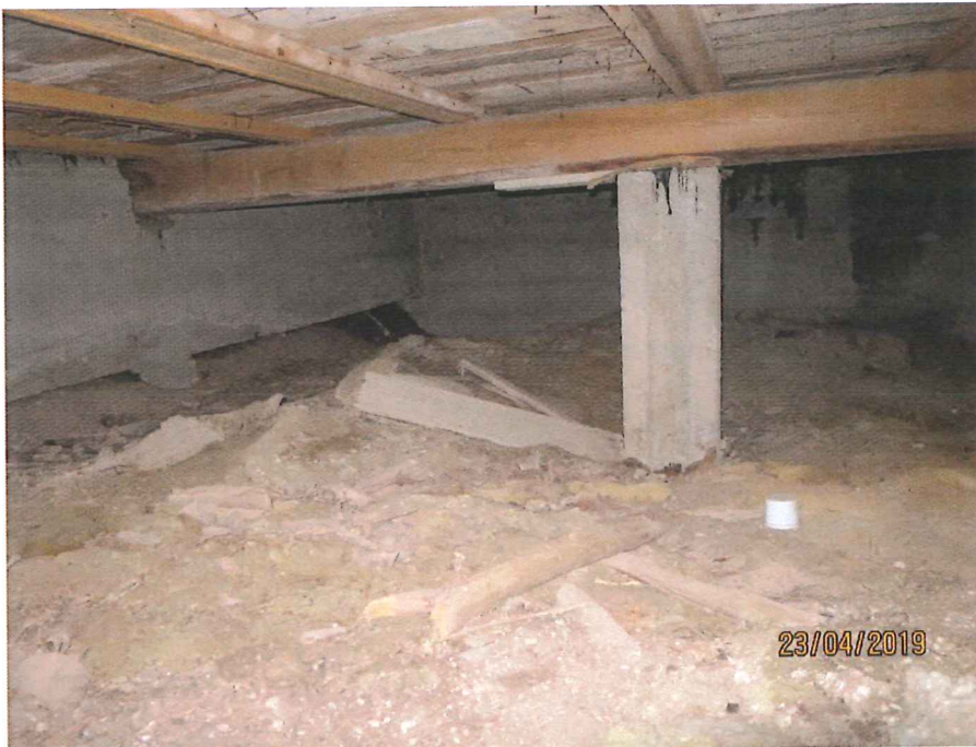
Kuva 9. Opettajainhuoneen alapuolisessa ryömintätilassa maapohjalla mikrobivaurioitunutta ainesta.
