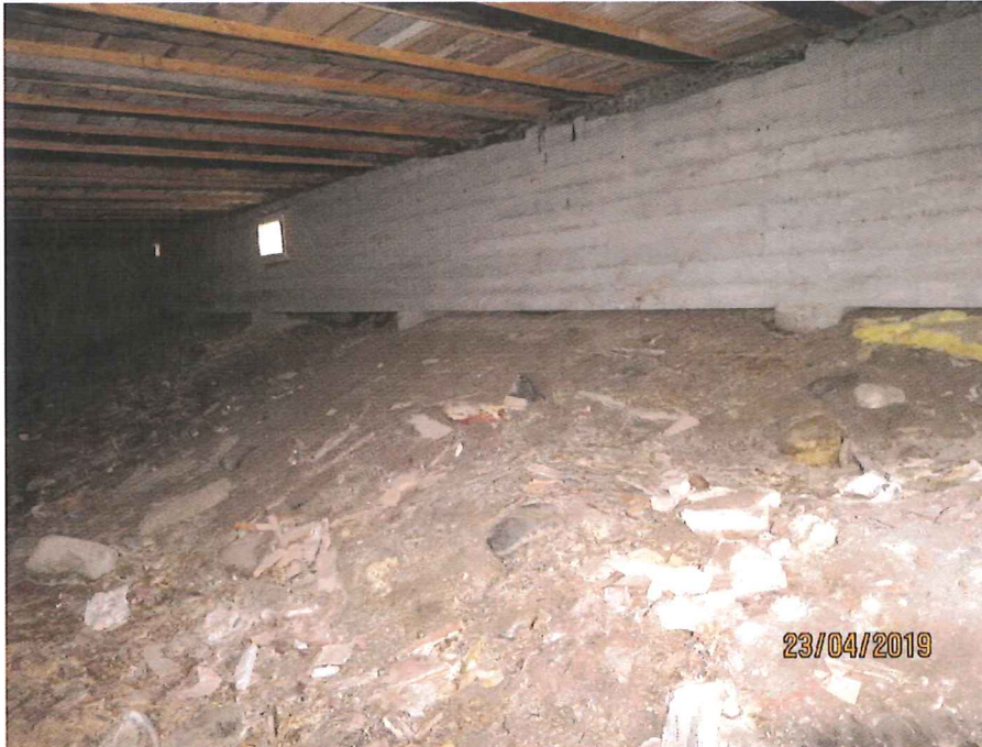
Kuva 4. Luokkasiiven ryömintätila, maapohjan pinnassa mikrobivaurioitunutta ainesta
