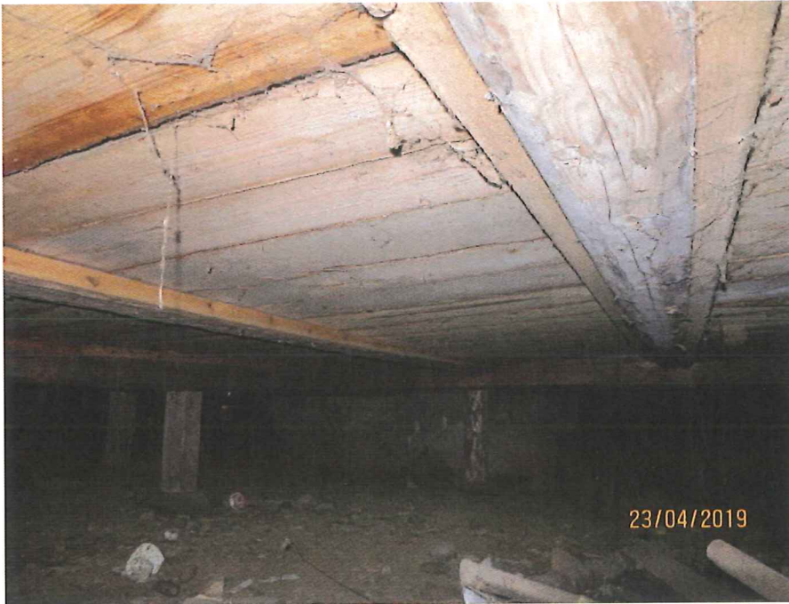
Kuva 1. Alapohjan puuosissa ei ole silmin havaittavia viitteitä kosteusvaurioista, ryömintätilan maapohjalla on orgaanista materiaalia ja muuta jätettä.
