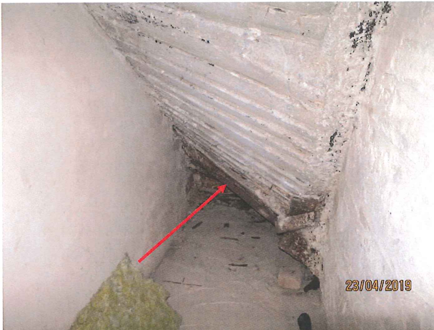
Kuva 8. Opettajainhuoneen kellarin portaikon alla purkamattomia muottilautoja.
