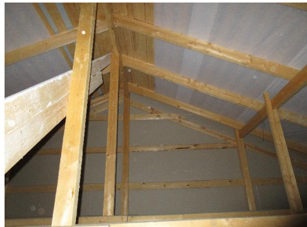
Kuva 26: Palokatkoseinät olivat tiiviitä.
