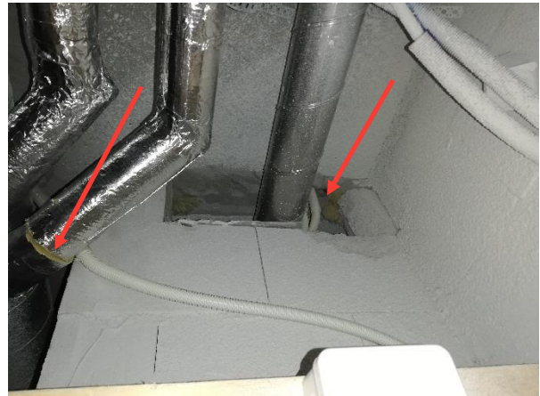
Kuva 19: Kuvaamataidon luokan varaston 096 sisäkattotilassa havaittiin kuitulähteitä.
