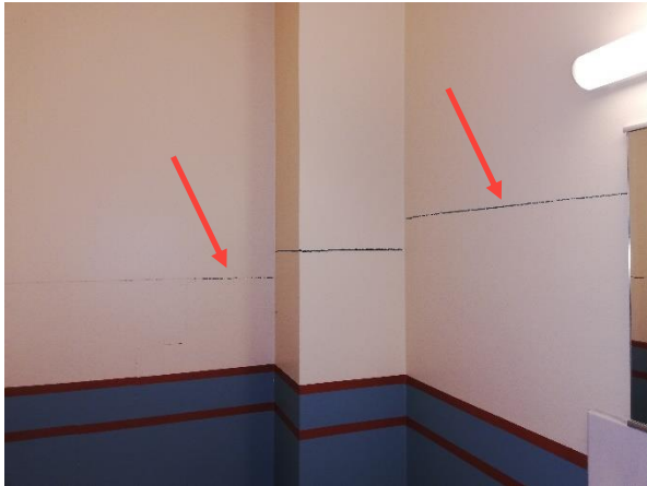
Kuva 21: Opettajien huoneen ja luokan 156 välisellä seinällä havaittiin vaakasuuntainen halkeama noin 1,5 metrin korkeudella lattiasta
