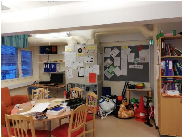
Kuva 30: Ilmanvaihtokone opettajainhuoneen vanhalla osalla.
