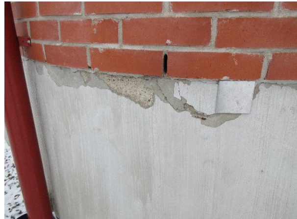
Kuva 4: Sokkelin rappaus on paikoitellen irronnut.
