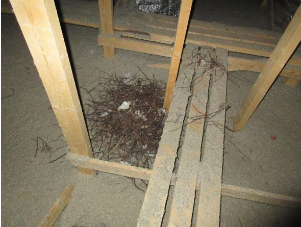
Kuva 29: Risukasa lämmöneristeiden päällä pohjois-päädyssä.
