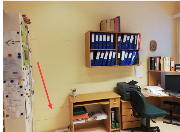
Kuva 22: Halkeama jatkui myös viereisen tilan 145 seinällä
