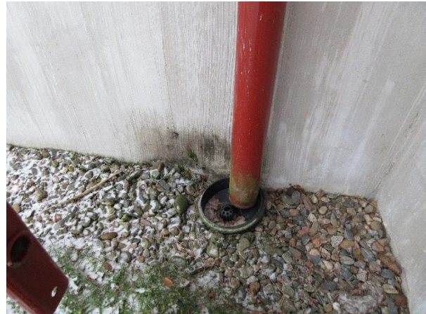
Kuva 2: Sokkelin pinta tummunut rännikaivon viereltä.
