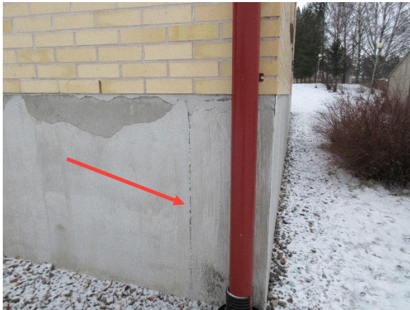
Kuva 3: Pystysuuntainen hiushalkeama rappauksessa sokkelielementin saumassa.
