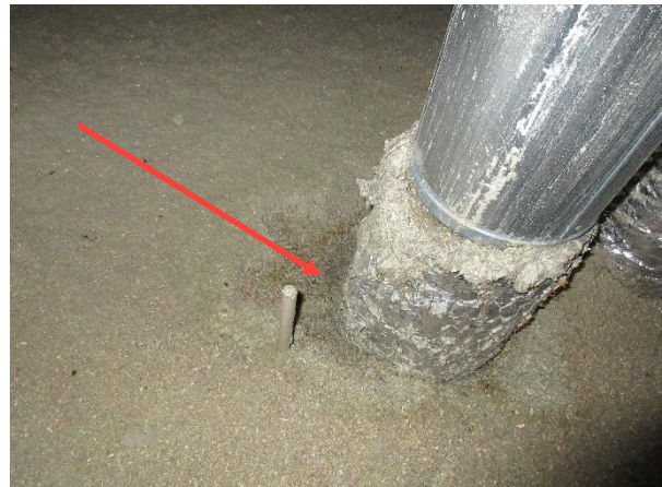
Kuva 28: Aluskatteen läpivientien kohdilla lämmöneristeessä havaittiin veden valumajälkiä.
