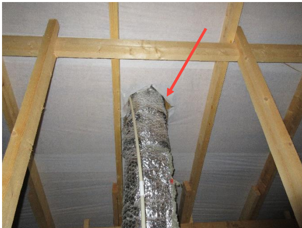
Kuva 27: Aluskatteen läpivientejä ei ollut tiivistetty.
