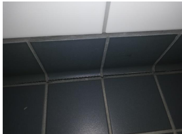
Kuva 11: Halkeama lattialaatoituksen saumassa 1. kerroksen wc:ssä 086.
