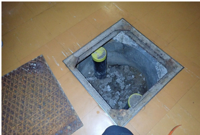
Kuva 29. Käytävällä on kaksi viemäreiden tarkastusluukkuja. Kaivoissa mikrobiperäinen haju. Kaivojen kannet eivät ole tiiviitä ja mikrobiperäistä hajua pääsee sisäilmaan. Toisessa kaivossa kaivon pohja oli betonoitu ja toinen ei
