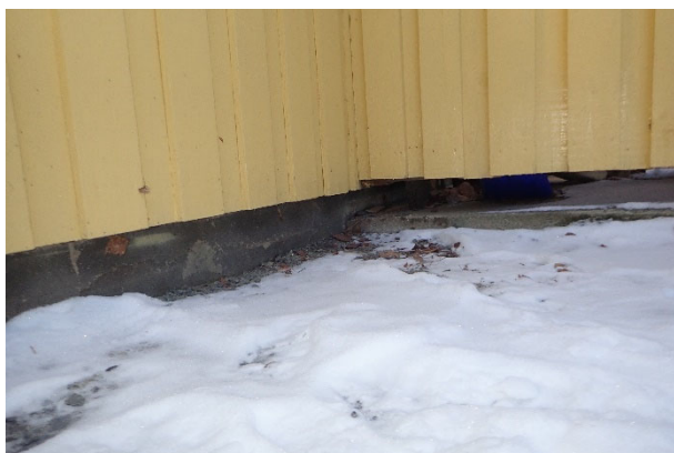
Kuva 15. Seinärakenteen alaosat sijaitsevat osittain maanpinnan tasolla tai maanpinnan alapuolella.
