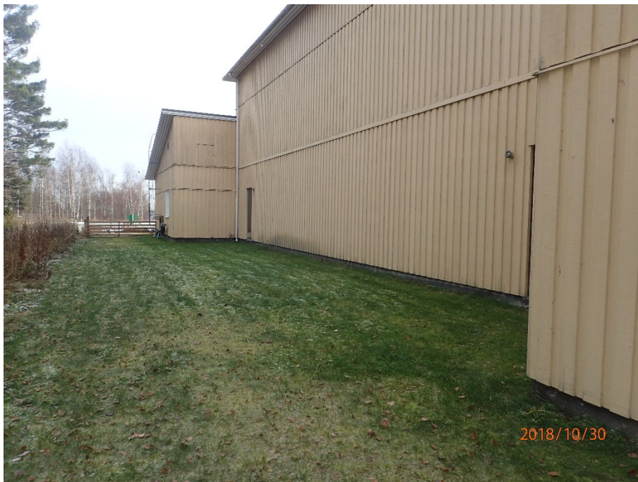
Kuva 19. Vesikaton sadevesi kastelee juhlasalin seinää paikallisesti.
