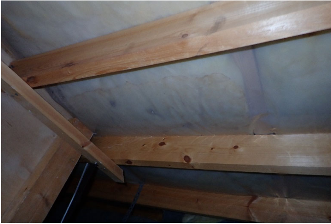
Kuva 35. Höyrysulun päällä oli nähtävillä merkkejä kuivuneista vesivuodoista
