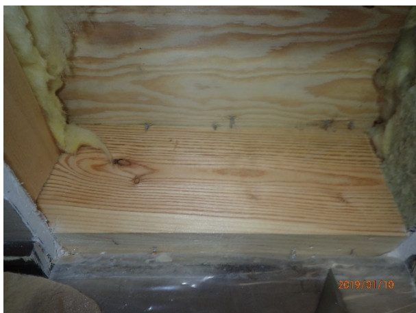
Kuva 6. Tuulensulkulevyinä on käytetty 3...4 mm vaneria. Vanerin sisäpinta oli aistinvaraisesti hyvässä kunnossa
