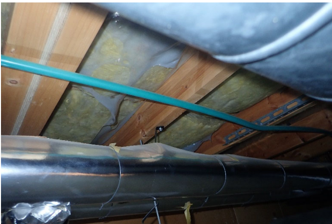
Kuva 37. Paikoitellen höyrysulku on sulanut hitsaustöiden vaikutuksesta pois.
