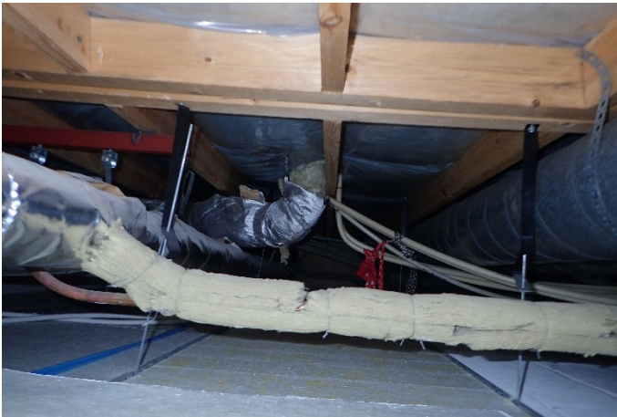
Kuva 36. Höyrysulun tiiveydessä on puutteita talotekniikan läpimenojen kohdalla
