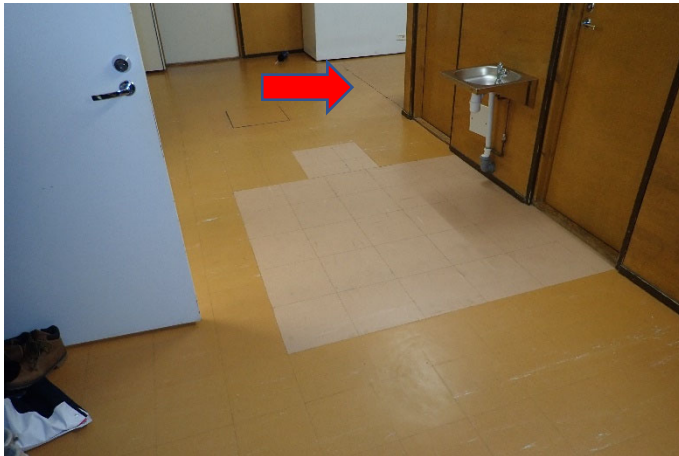
Kuva 30. Paikattu kohta käytävällä. Korjattu kohta oli märkä ja laatat olivat kosteuskuormituksen vaikutuksesta irti alustasta. Korjaus on tehty viemäri-rikon vuoksi. Punaisen nuolen kohdalla liikuntasäuma. Liikuntasäumasta saattaa olla suora yhteys alapohjan maatayttyöön.
