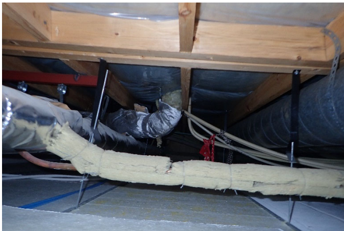
Kuva 36. Höyrysulun tiiveydessä on puutteita talotekniikan läpimenojen kohdalla
