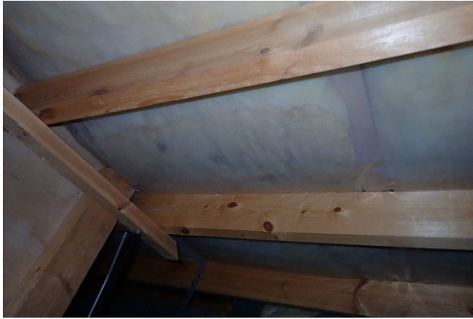
Kuva 35. Höyrysulun päällä oli nähtävillä merkkejä kuivuneista vesivuodoista
