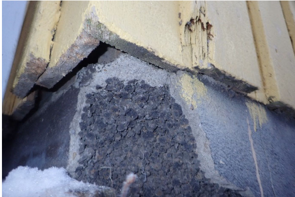
Kuva 16. Perusmuurin rappauksessa havaittiin useita vauriokohtia
