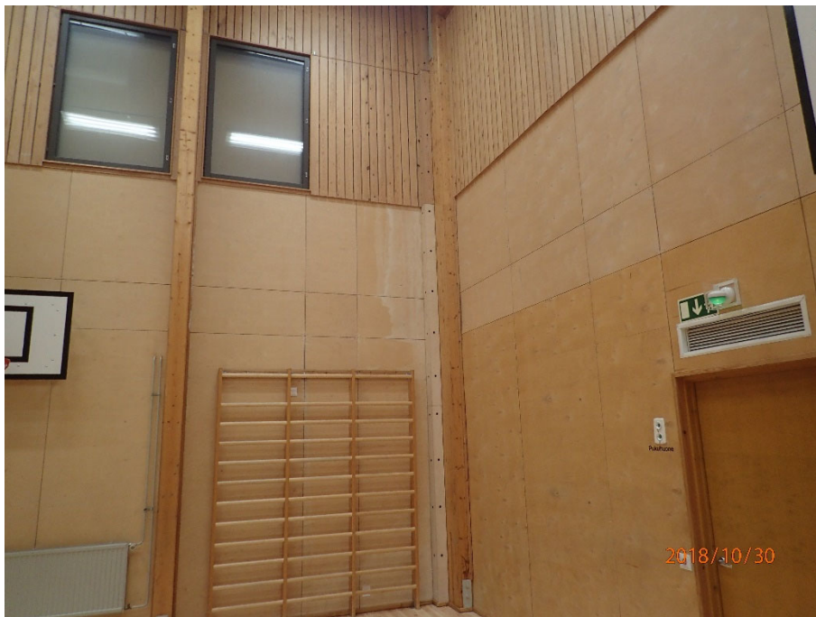
Kuva 20. Juhlasalissa on näkyvillä vanhoja tasakaton aiheuttamia vuotojälkiä.
