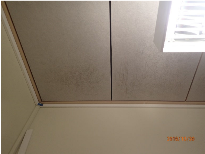
Kuva 38. Akustovillojen sisäpinnalla oli mustaa väripoikkeamaa. Akustovillan sisäpinnasta otettiin materiaalinäyte mikrobianalyysiin.
