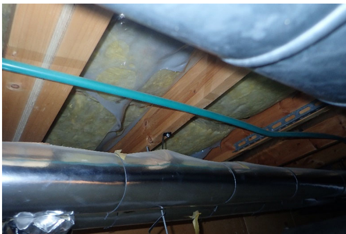
Kuva 37. Paikoitellen höyrysulku on sulanut hitsaustöiden vaikutuksesta pois.
