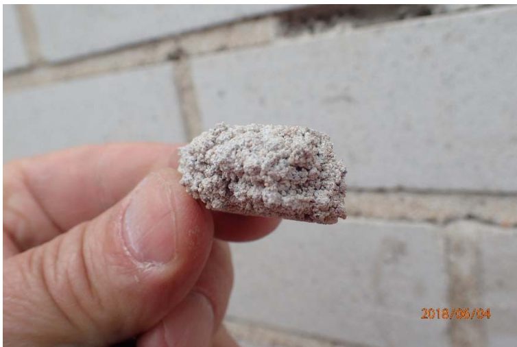
Kuva 14. Jälkisaumaukseen käytetty muurauslaasti rapautuu herkästi.
