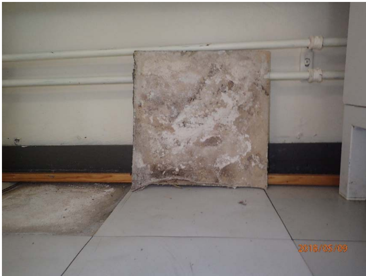
Kuva 24. Luokan 13 mikrobivaurioitunutta lattiapinnoitetta.
