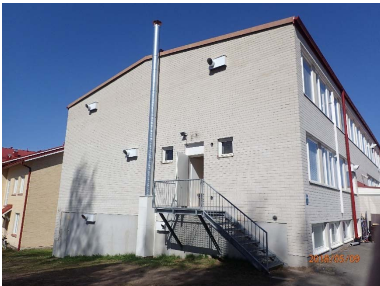
Kuva 3. Eteläjulkisivu ja näkymä lukion suuntaan. Kuvassa näkyy kellarin alapohjan alapuolisen putkikanaalin alipaineistusjärjestelmä.
