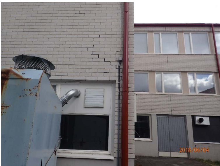
Kuva 15. Julkisivussa on useita kohtia, mistä sadevesi pääsee helposti eristetilaan.
