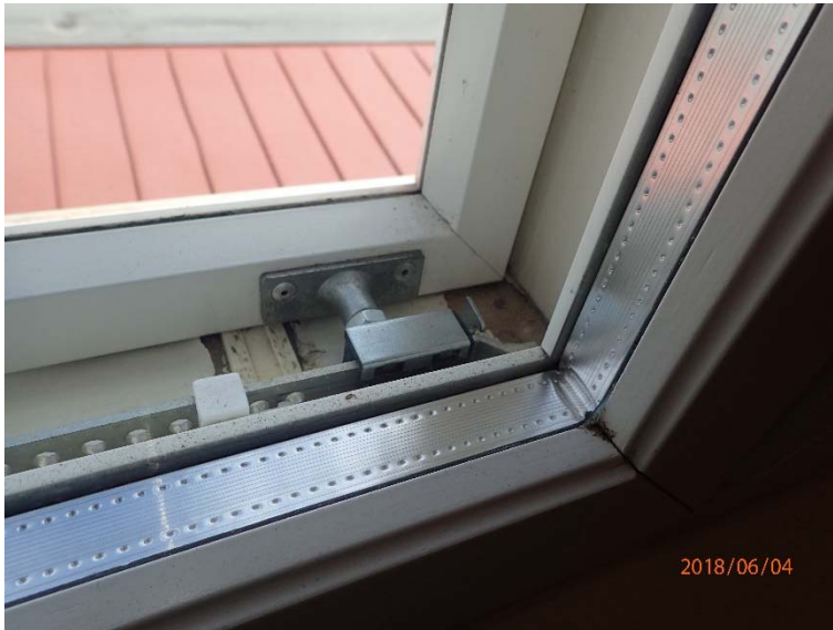
Kuva 8. Ulkopuitteen kautta päässyt vettä ikkunalasien välitilaan.
