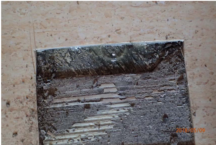
Kuva 18. Vettä muovimatton alla.
