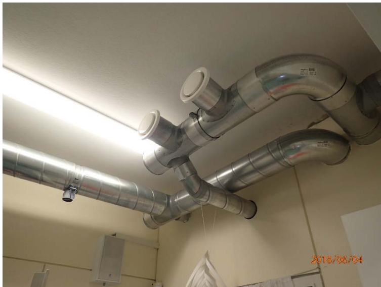
Kuva 26. Kellariin rakennettu ilmanvaihtojärjestelmä.
