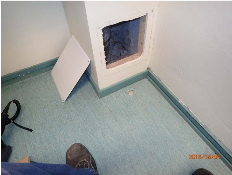
Kuva 22. Opettajanhuoneen talotekniikkakuilusta havaittiin voimakas ilmavirtaus sisätiloihin. Kuilun edustalla matto oli irti alustasta.
