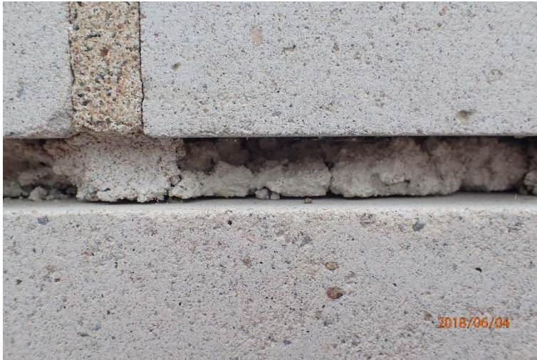
Kuva 13. Julkisivumuurauksen vedenpidätyskyvyssä on puutteita.
