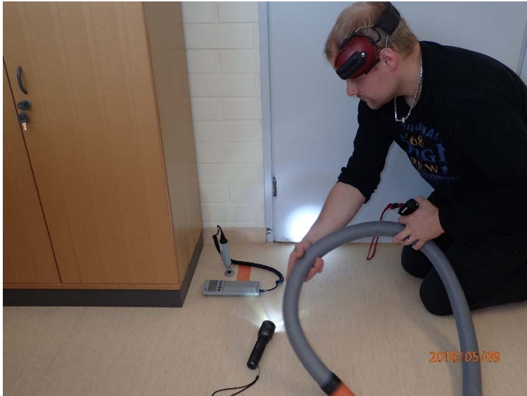
Kuva 20. Vesivahinko ulottuu koko tilaan. Laajuus tulee selvittää.
