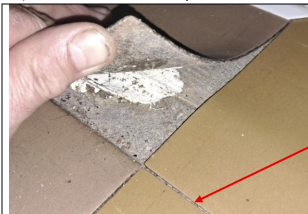
Muovilaatan alla lastulevy on tummunut. Laatan sauma on avoin
