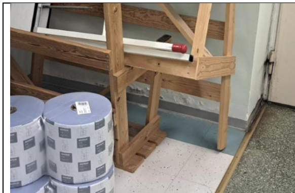
Aula 028 seinäalareunassa "hilseilyä"
