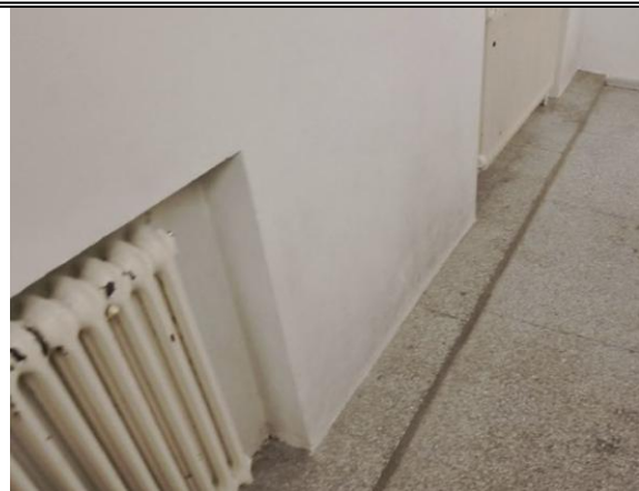
Pukuhuoneen seinän alareunassa tummentumaa
