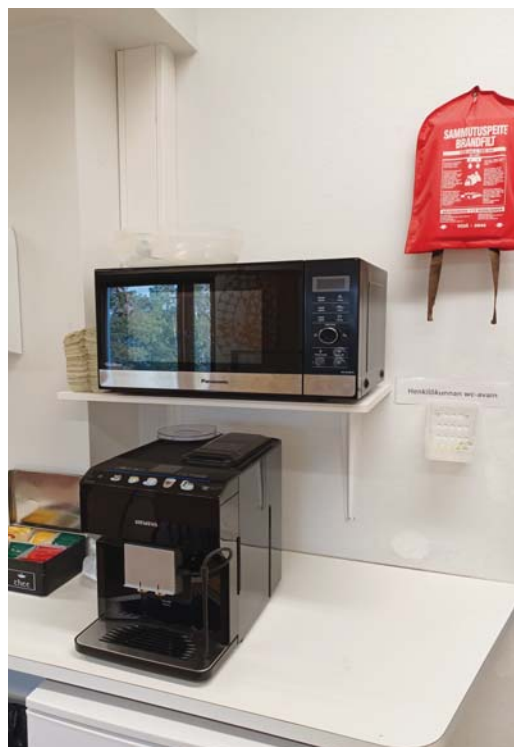
Varmistu sähkölaitteen turvallisuudesta!
