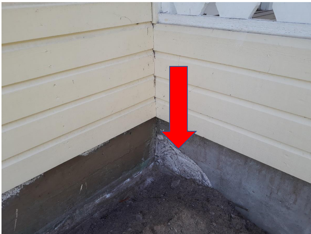
Kuva 6. Uuden osan sokkelissa on rakennusvaiheen virhe osoitettu punaisella nuolella.
