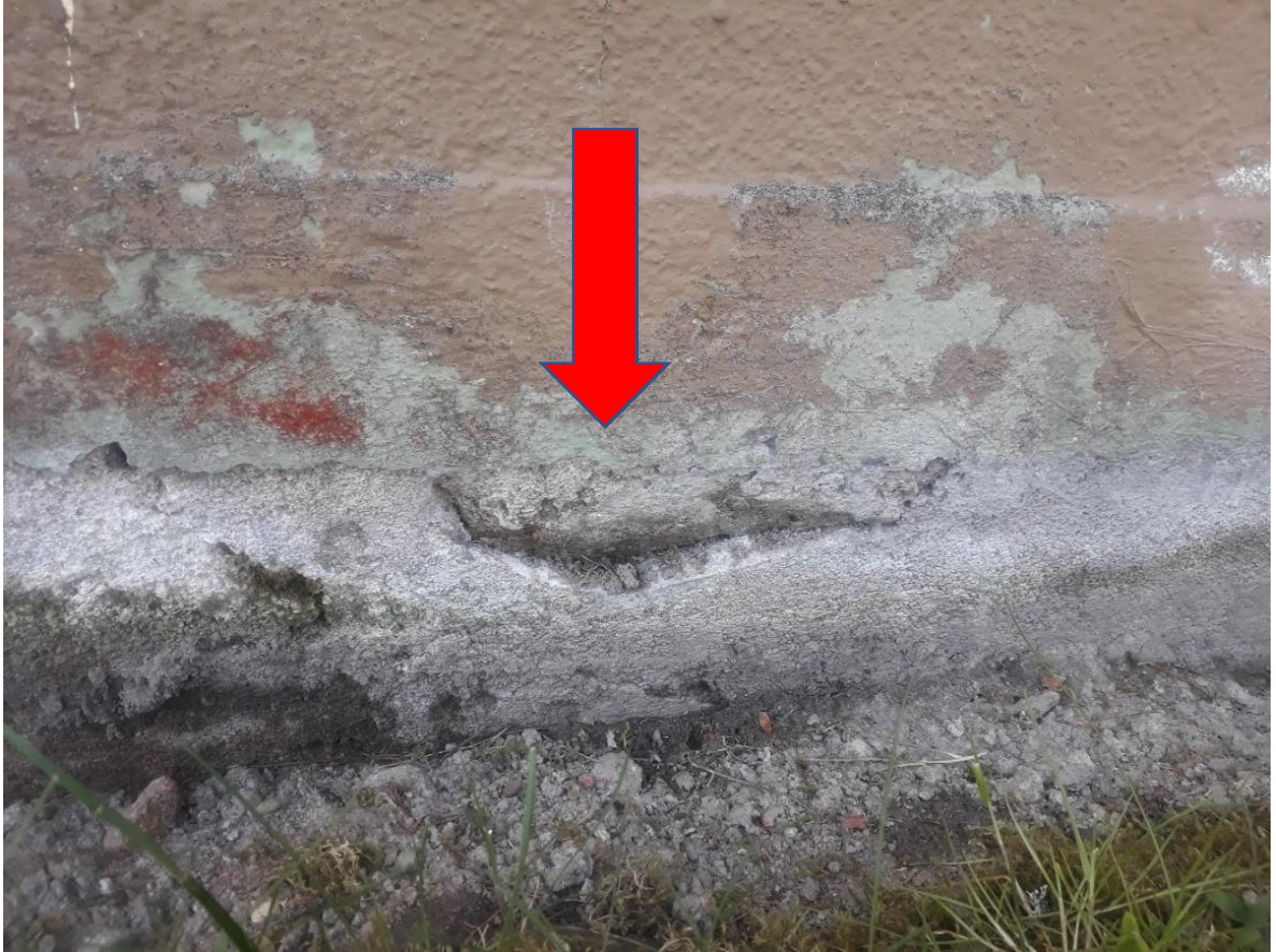
Kuva 7. Kiinteistön vanhan osan sokkelin rapautuma, joka on pakko korjata.
