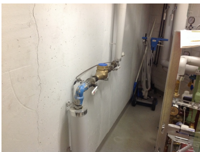
Veden pääsulku lämmönjakohuoneessa
