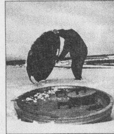
Metaanikaivossa on suojakupu.
