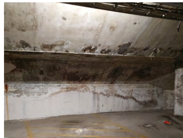
Pysäköintihallin katto on rapistunut torin portaiden kohdalta.
