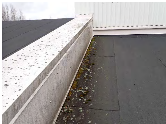
Kuva 49. Vesikatteella alkavaa sammaloitumista.
