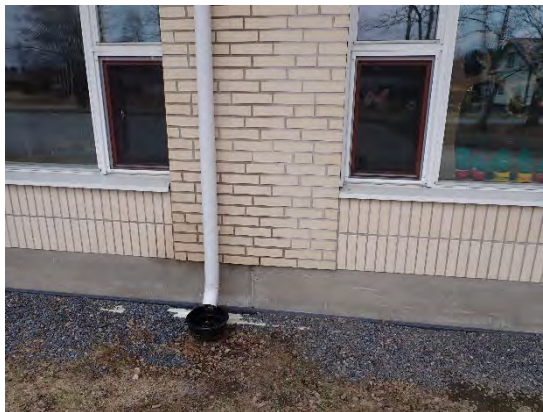
Kuva 6. Syksytorvi padottanut ja vuotovesi päässyt kuormittamaan ulkoseinärakennetta.
