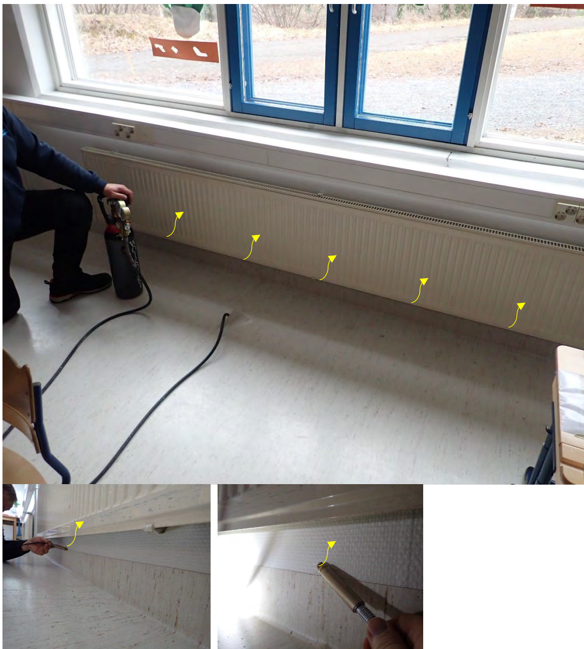
Kuvat 18–20. Huonetila ensimmäisestä kerroksesta. Todettuja ilmvuotokohtia osoitettu keltaisilla nuolilla.
