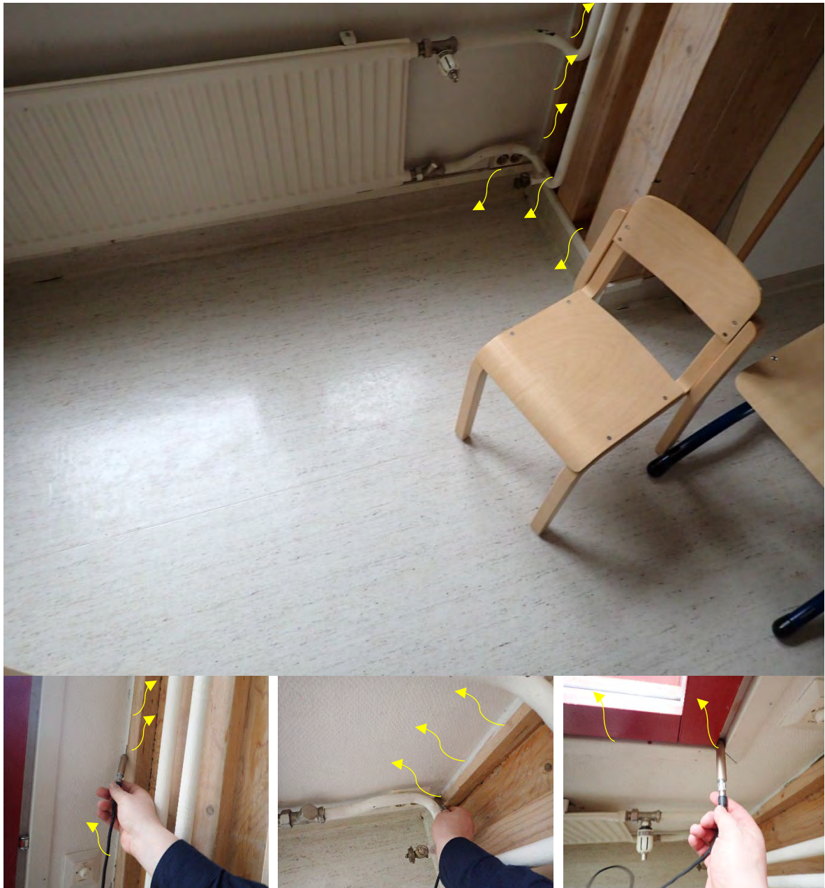
Kuvat 36–39. ME2, luokkahuone. Todettuja ilmavuotokohtia osoitettu keltaisilla nuolilla.
