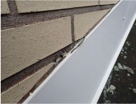
Kuva 52. Pellin tiivistys huonokuntoinen.
