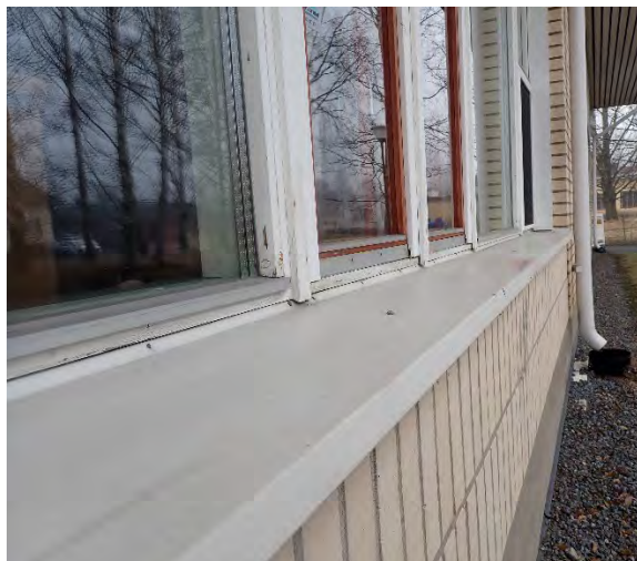
Kuva 28. Ikkunoiden vesipeltien kaato arvioitiin riittäväksi.
