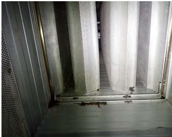
Kuva 68. IV-koneen sisällä roskaa.
