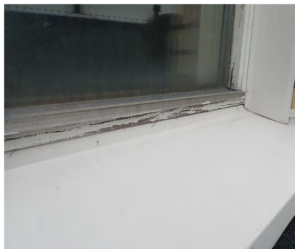
Kuva 26. Kuva rakennuksen ikkunasta vesikatolta. Puitteet osin huonokuntoisia.
