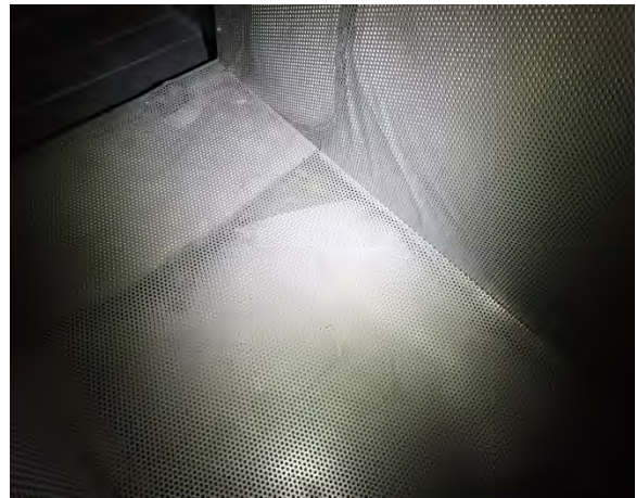
Kuva 69. IV-koneen äänieristysvillojen suojapaperi osin poissa paikoiltaan.
